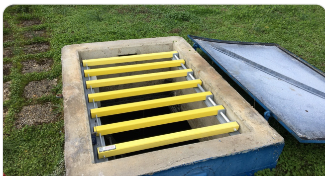
Poste équipé – grille anti-chute en place.
