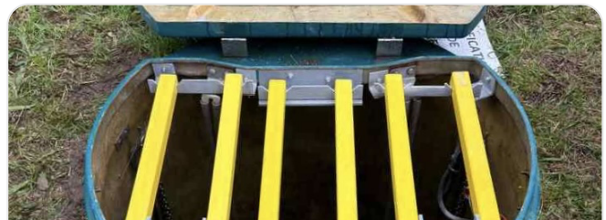
En situation – poste équipé (ID-BAC-GC).
